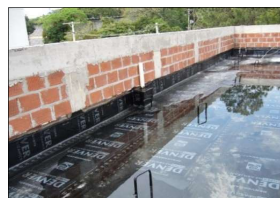
Platibanda com a ancoragem da impermeabilização efetuada no rebaixo para essa finalidade.
