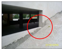
Parede lateral de rampa de veículos com o reboco já executado e com o vão da esquadria de ventilação do pavimento interferindo com a continuidade necessária para o desenvolvimento do rodapé.
