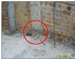
Rebaixo inadequado para o rodapé e com falta de uniformidade na sua dimensão vertical, no topo de uma rampa de veículos.
