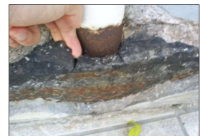
Corrosão do montante do guarda-corpo, envelhecimento e descolamento da impermeabilização e entrada de água entre os materiais.
